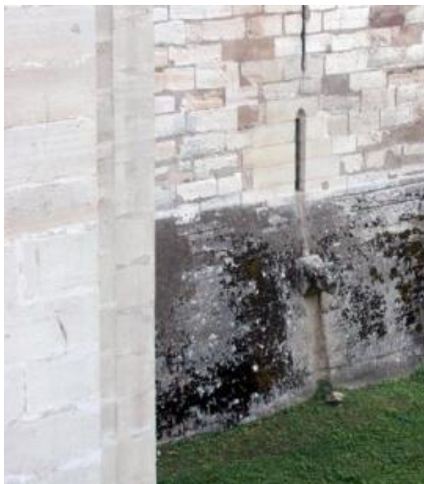
Sortie de l'égout collecteur médiéval du château dans les fossés est (photo ERCVBE, J. Chapelot)
